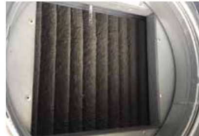
Exemple de filtre non remplacé au moment opportun
